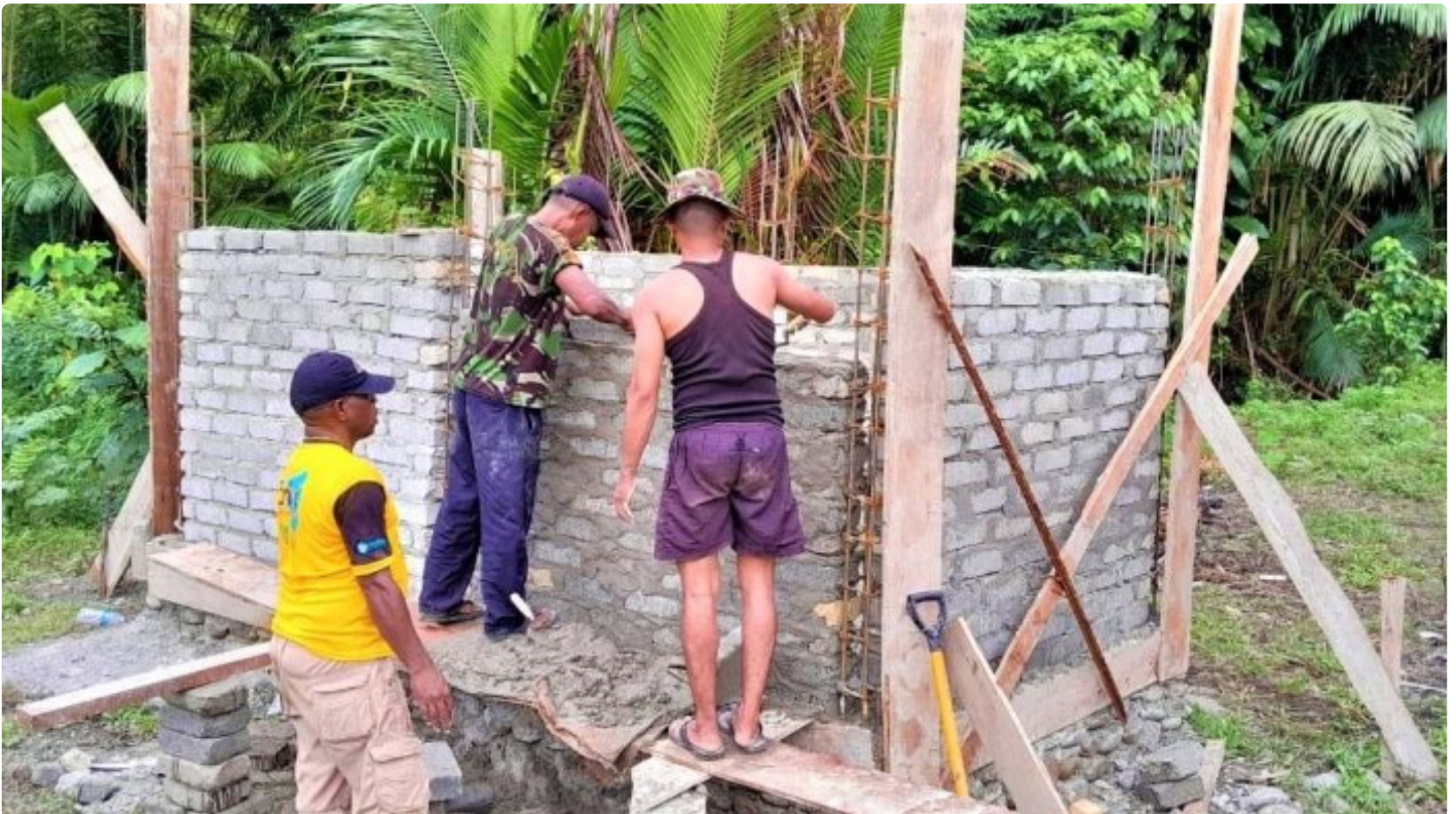
Satgas TMMD Saat Membuat Bak Penampungan Air Bersih Untuk Warga Kampung Muara Nawa
